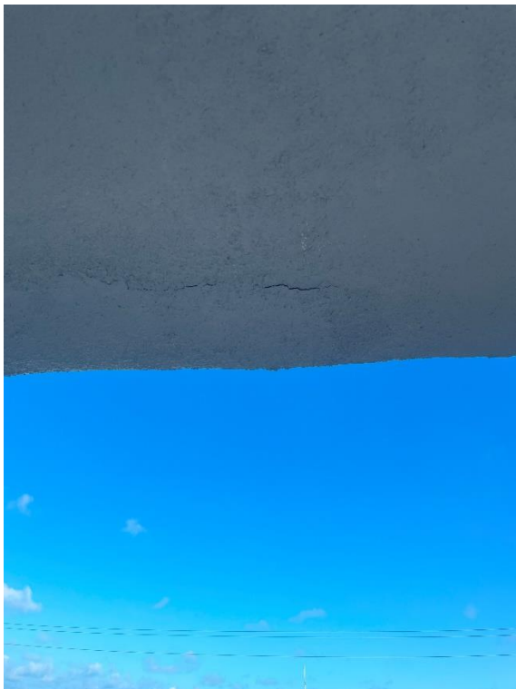
Photo #13 - Edge Spall
